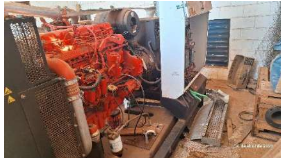
Gerador com os cabos cortados por conta do roubo
