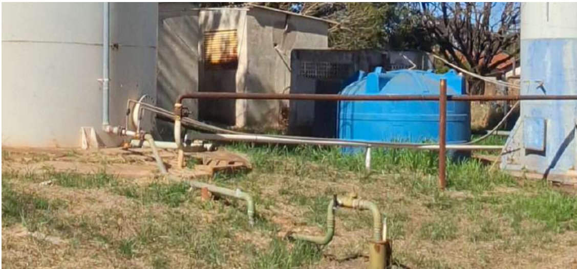
P11 – Registro do poço sem medidor
