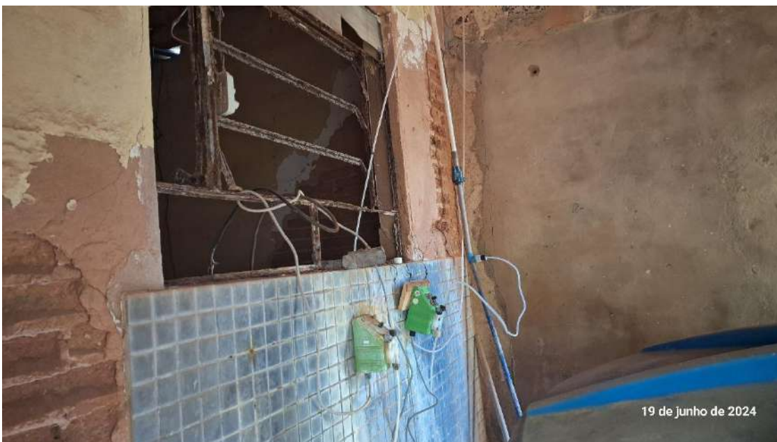
CRD06 – Sistema de tratamento – Detalhes das bombas dosadoras
