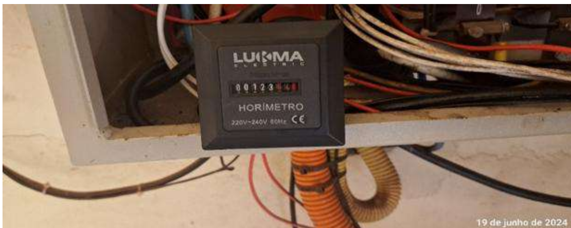
P11 – Painel elétrico de operação do poço com instalação de horímetro.
