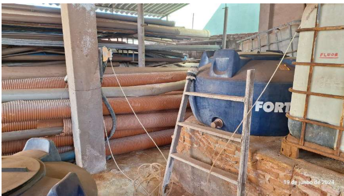
CRD01 – Sistema de tratamento – Mangueiras expostas e enroladas pelo chão
