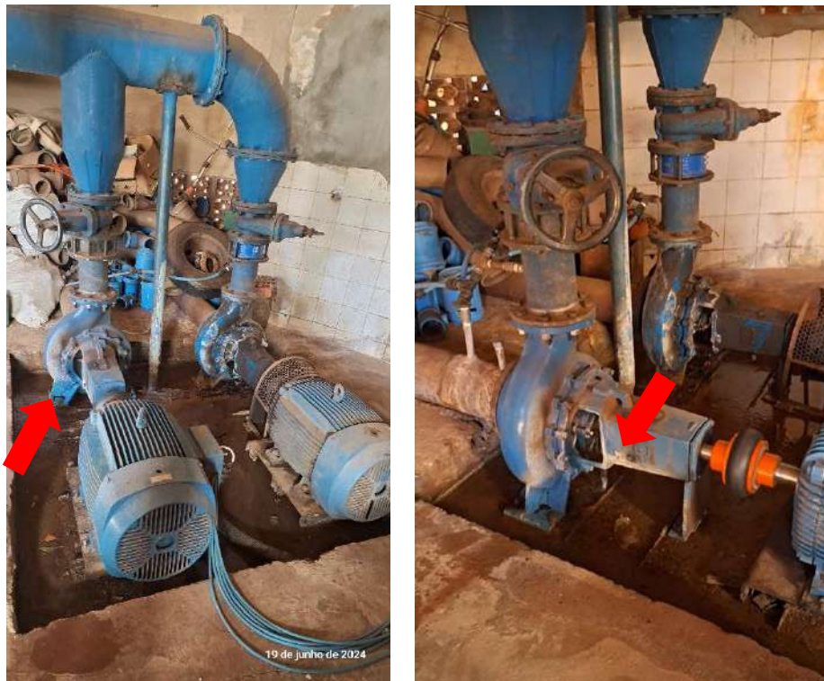
CRD01 – Vazamento na bomba
