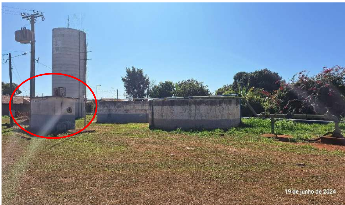
P10 – Detalhe da cabine de energia com ar-condicionado danificado.
