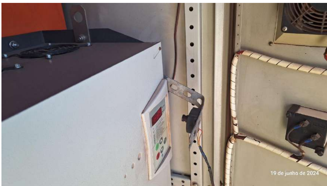
P10 – Instalação improvisada de câmera de segurança dentro da cabine de energia
