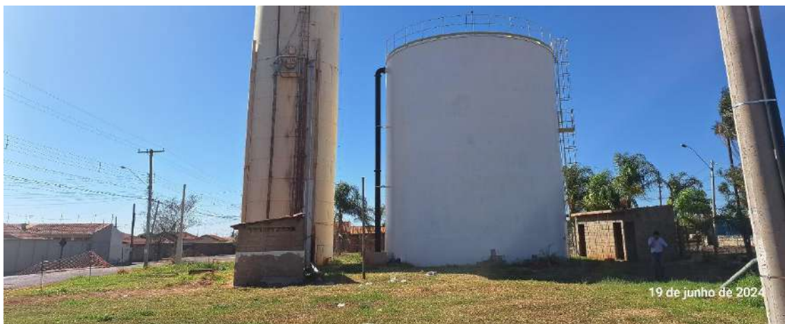
P09-A – Vista Geral do local – Falta de segurança por ausência de alambrado
